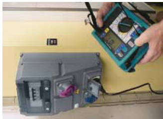
< La mesure sur site de la valeur de court-circuit en bout de ligne permet de valider pratiquement les choix de protection
