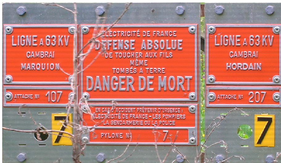
Photo de la plaque apposée sur un pylône HTB.
